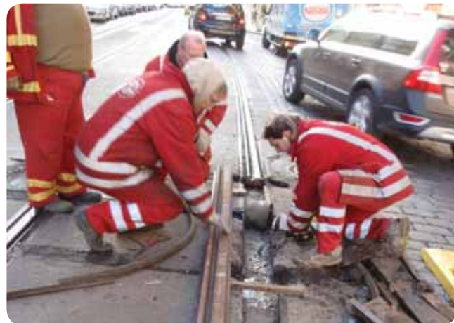
Hotová beznaděj: do panelů bez žlabů se pracovníci vrchní stavby snaží instalovat kus nové kolejnice.
