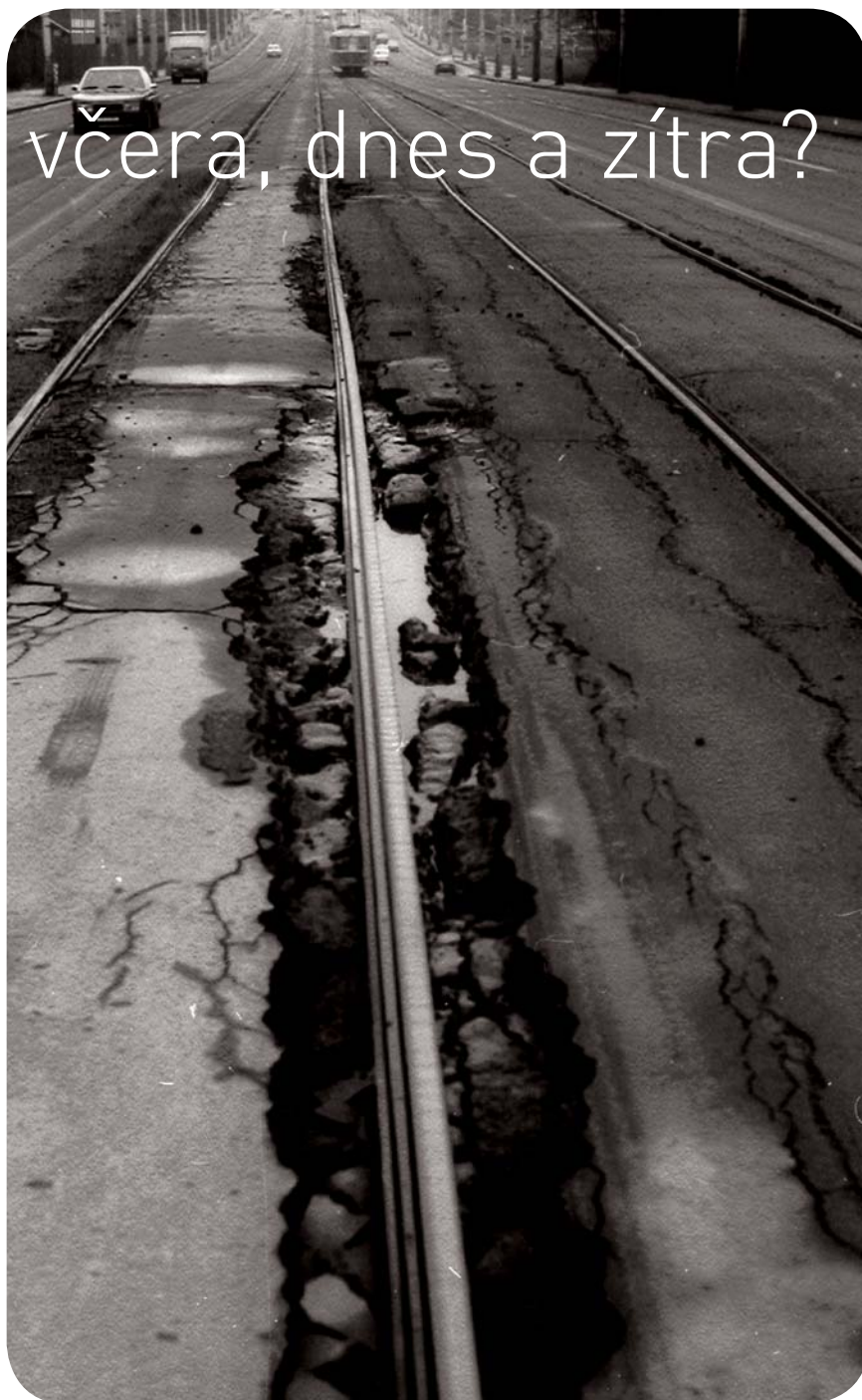
Tramvajová trať na Evropské ulici před panelizací. Její stav, podobně jako většiny původních tratí, byl otřesný. Foto: Archiv DP
