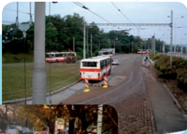
Ukončení NAD X-3 v obratišti Levského.
