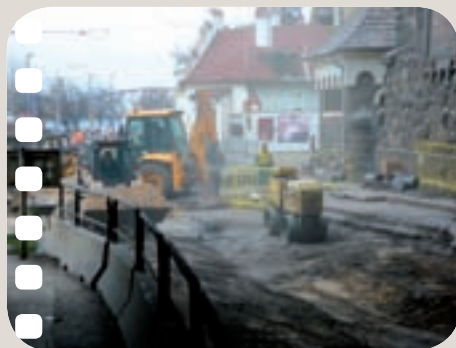
Pátý den výluky. Průhled z tunelu k Výtoni. Není kámen na kameni.
