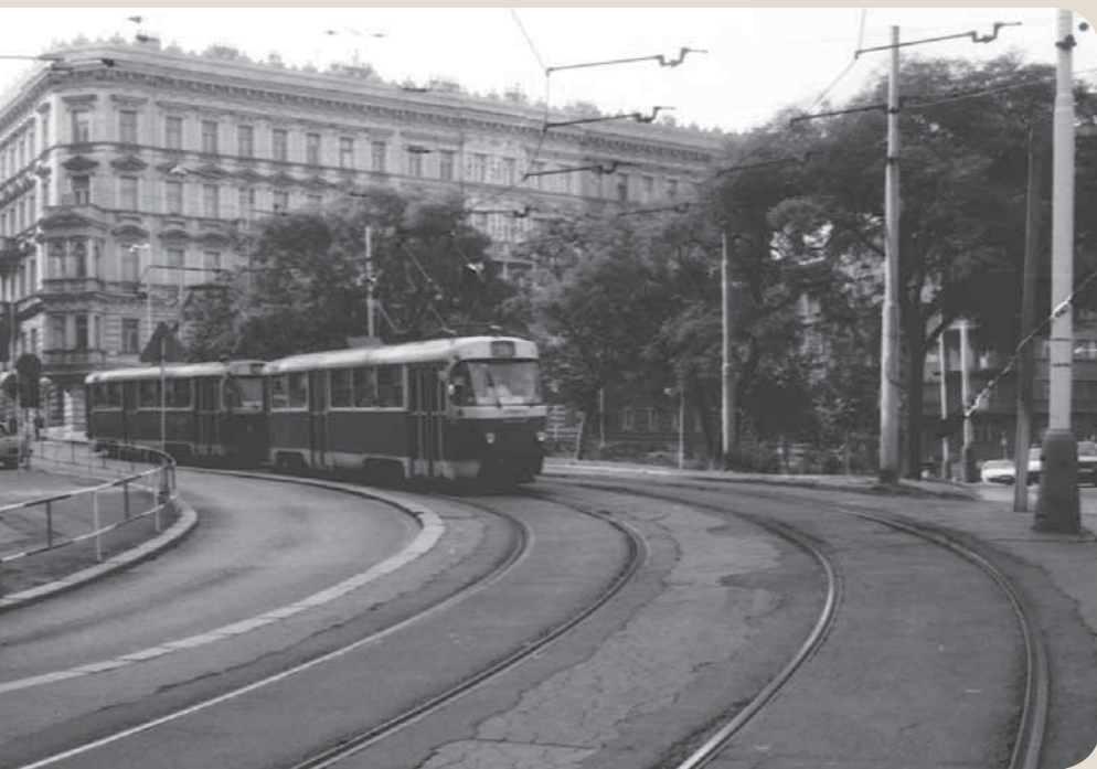
Tramvajová trať ve Škrétově ulici pochází z let 1966 a 1978. Snímek je z 31. srpna 1990 a stav trati zůstává od té doby setrvalý, rekonstrukce metodou BKV se už nedočkal.
