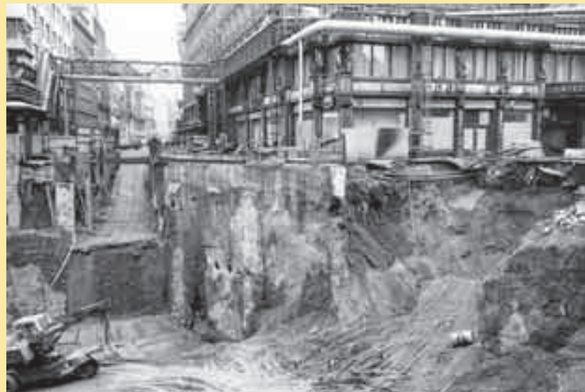
Na Mustku bylo dlouho staveniště stanice na trati A. Podchod patřící „áčku“ je použitelný i pro trať B. „Béčko“ má ale i vlastní vestibul pod Jungmannovým náměstím. Málokoho asi napadne, že stanice Mustek je na trati B nejhlubší (40,3 m). Stavební jáma byla zhruba tak hluboká, jako byla výška okolních domů. Tramvaje tu jezdily po jednokolejných provizoriích.
