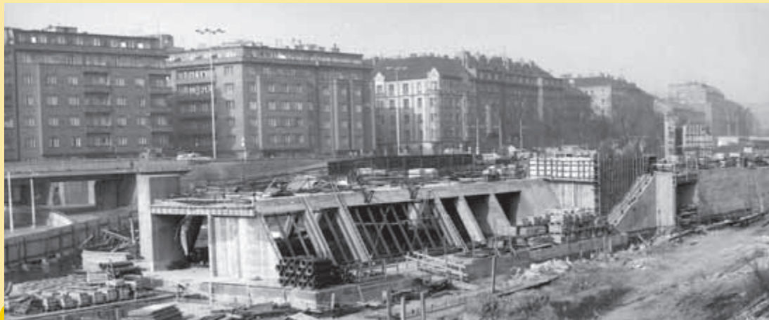
Výstavbu stanice Vltavská mohli sledovat mnozí zaměstnanci Dopravního podniku z oken svých kanceláří. Tato fotografie byla pořízena z Negrelliho viaduktu.
