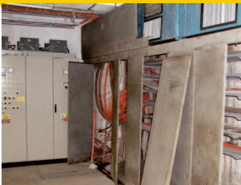
V této strojovně eskalátorů se ještě tahají kabely pro jiná zařízení.
