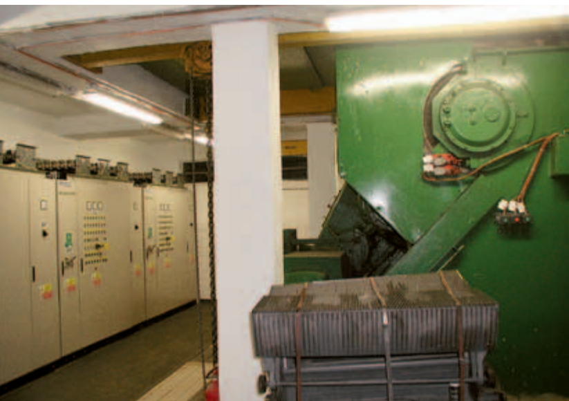
Ve strojovně eskalátorů jsou nově osazené rozvaděče a elektrovýzbroj je také nová. Eskalátory jsou ve strojní části původní. Byly většinou vyměněny jenom ty části, které bylo nutné vyměnit pro rychlé zprovoznění.
