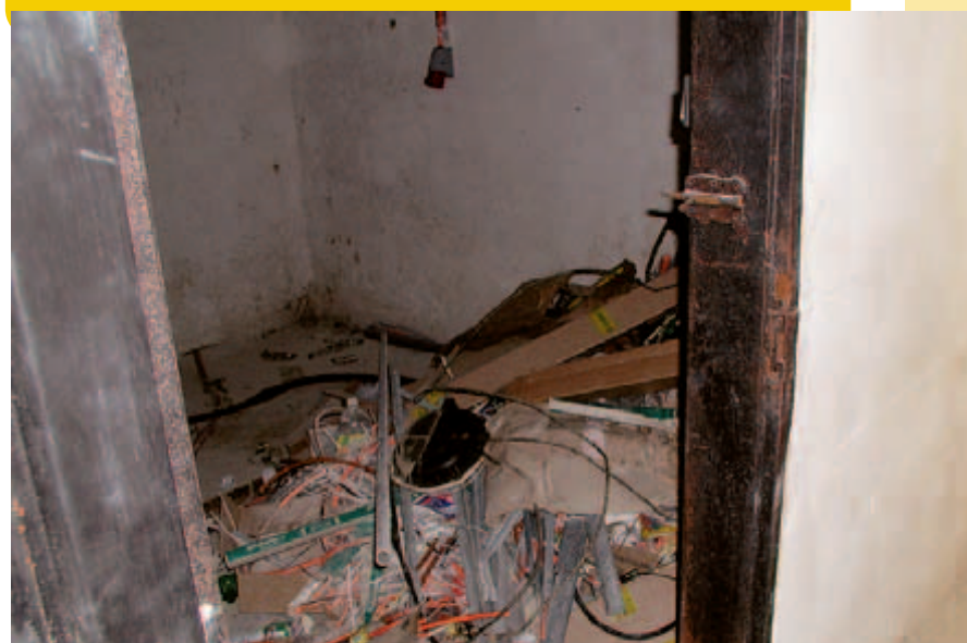
Ve stanici se najdou místnosti a zákoutí, kde zůstal nepořádek po dodavatelích. Postupně by nepořádek měl zmizet i z těchto míst.
