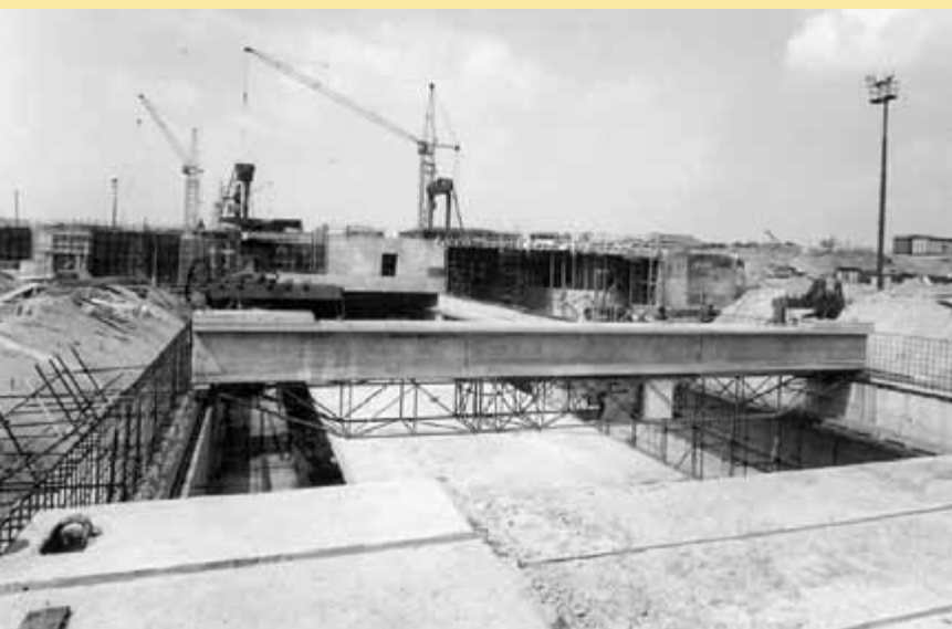
Jen málokdo by z tohoto snímku poznal dnešní hloubenou stanici Nové Butovice. Právě tak vypadala v květnu 1986. Jistě se nedivíte, že bez výrazných orientačních bodů v okolí nebyla stavba pro fotografy příliš atraktivní. Foto: Archiv DP
