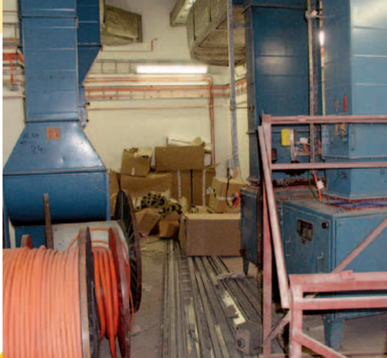
Strojovna vzduchotechniky o několik desítek metrů dál na trati B. Rozdíl více než patrný. Zařízení původní a strojovna dočasně jako mezisklad pro dodavatele.
