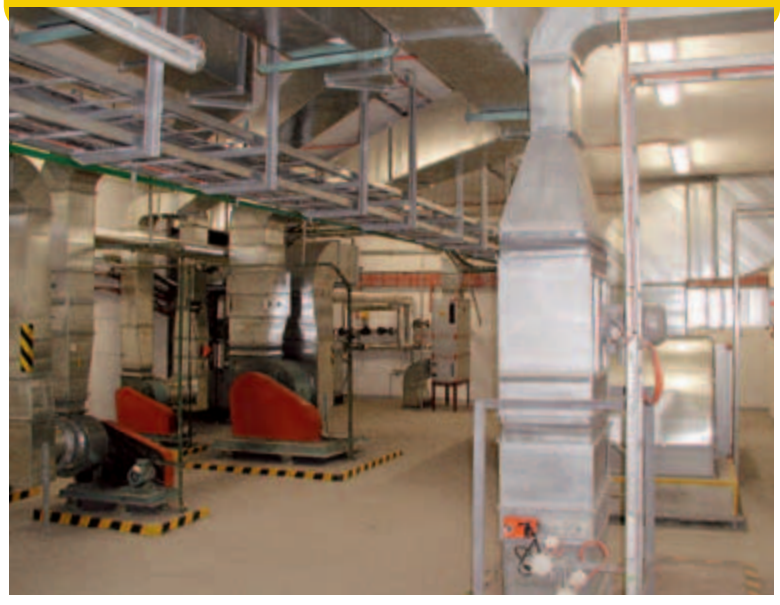
V této strojovně vzduchotechniky na trati C je většina zařízení nová nebo repasovaná.
