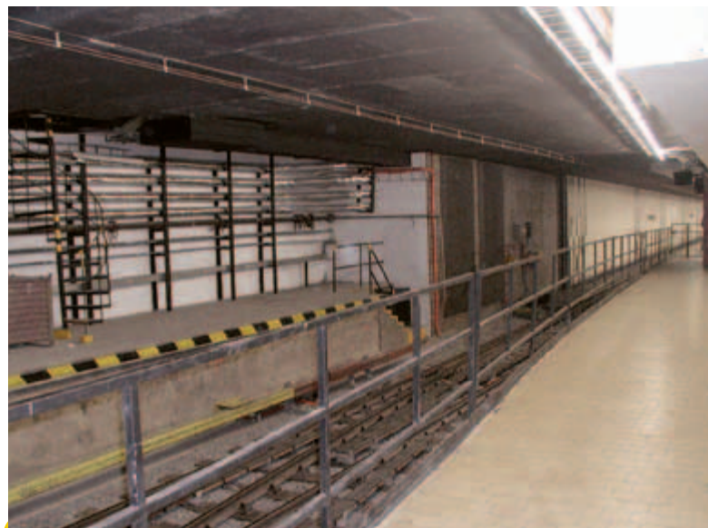
Zde se před rokem proháněly bagry. Nikoho by nenapadlo, že i štrkové lože muselo být vyměněno. Doba, kdy zde pracovaly těžké stroje a měnily podloží, je nenávratně pryč.
