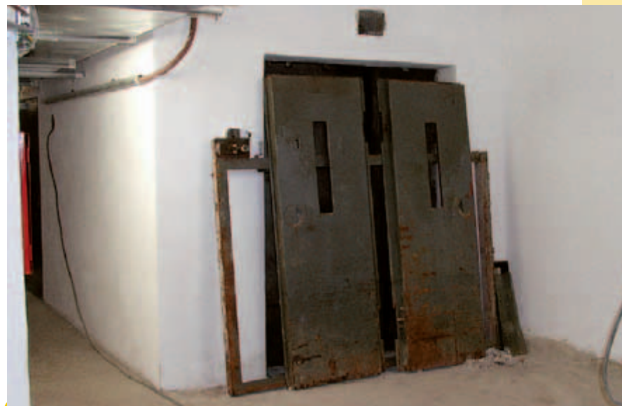
Nákladní výtahy se opravují postupně včetně výměn dveří. Ty byly většinou vodou a obrovským tlakem vytrhány a zprohýbány.
