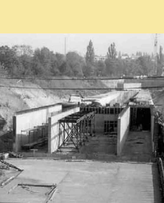
Ze stejné doby je fotografie rozestavěných tunelů u stanice Švermova (dnes Jinonice). Také tady bychom bez popisku jen těžko poznali, o kterou část Prahy jde. Foto: Archiv DP
