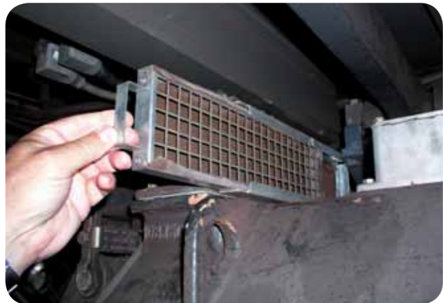
Znečištěné filtrační vložky v držáku namontovaném na sacím hrdle trakčního motoru (fotografováno pod vozem)
