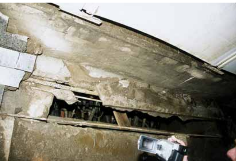
Díra v podlaze přestupního tunelu ve stanici Můstek. Tudy se dostávala voda z tratě B do stanic tratě A, neboť stěna nebyla postavena podle projektové dokumentace, metrová zeď byla nahrazena několikacentimetrovou příčkou...
