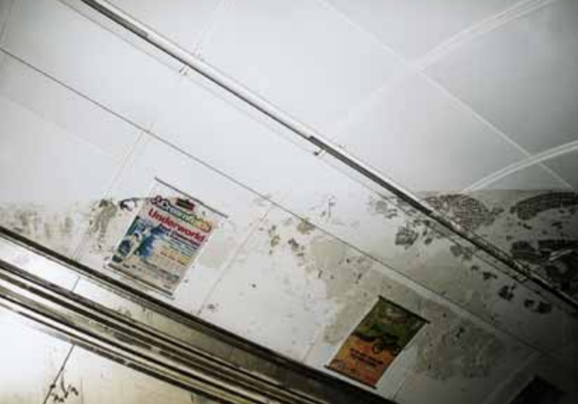
Vstupujeme z Václavského náměstí do stanice Můstek tratě A. K nástupišti nám zbývá zdolat ještě dvě třetiny eskalátorového tunelu... V těchto místech se zastavila voda, jak o tom svědčí stopa na obložení.
