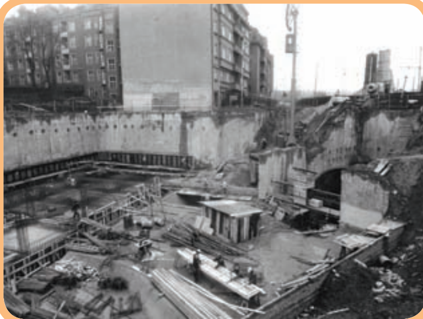
Na místě zbořených domů na jižní straně křižovatky s ulicí K Brusce vznikla velká stavební jáma budoucího podchodu a vestibulu metra. Patrný je i rozestavěný eskalátorový tunel. Foto: Archiv DP; ČTK
