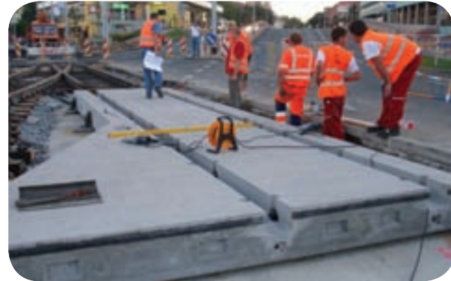
Panely se postupně usadí na dokonale únosný podklad. Mezi sebou jsou propojeny svorníky. Sestava je podlita samonivelační hmotou, aby uložení bylo co možná nejdokonalejší, a nikoliv jen bodové. Důraz je kladen i na ochranu proti vniknutí vody do konstrukce.
