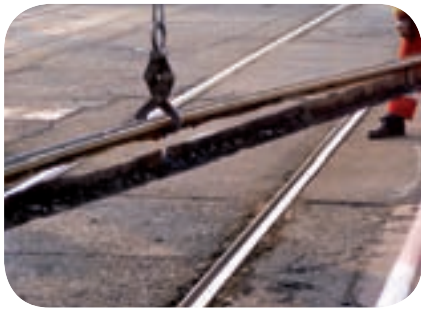
I takto havarované kolejnice byly k vidění v Olšanské ulici.
