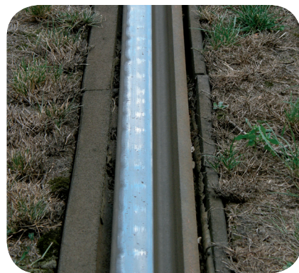
Kolejnice před odstraněním vlnkovitosti.
