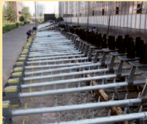
Součástí rekonstrukce byla výměna návěstidel. Nová návěstidla připravená na montáž. Pracovníci firem provádějí závěrečnou kompletaci. Obdobně se připravovalo i osvětlení pro zhlaví.
