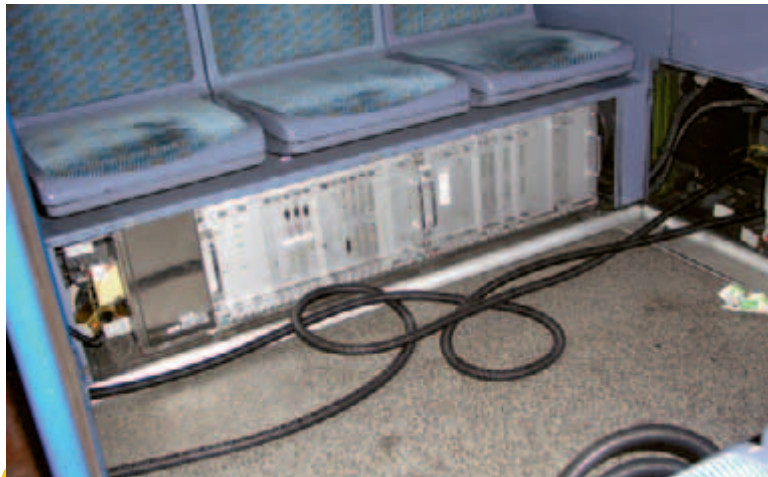
Rídicí systém vlaku je umístěn v čele vozu a částečně pod sedačkami. Z důvodu dosažení velmi vysoké míry provozní spolehlivosti je zdvojen – 100% zálohovanost.
