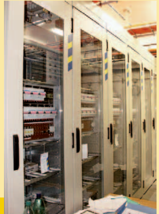
Skříně pro umístění počítačů elektronického stavědla.
