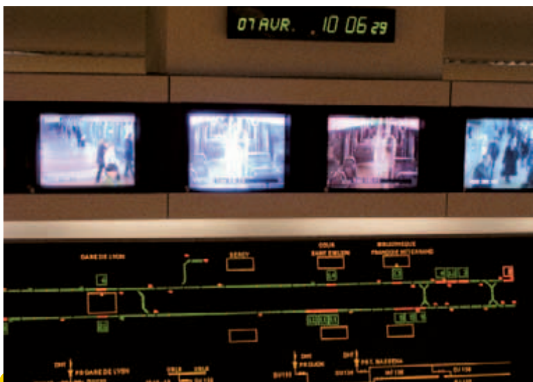
Detailní pohled na přehledový panel linky a na obrazovky monitorující nástupišť a prostor pro cestující včetně vlakových souprav.
