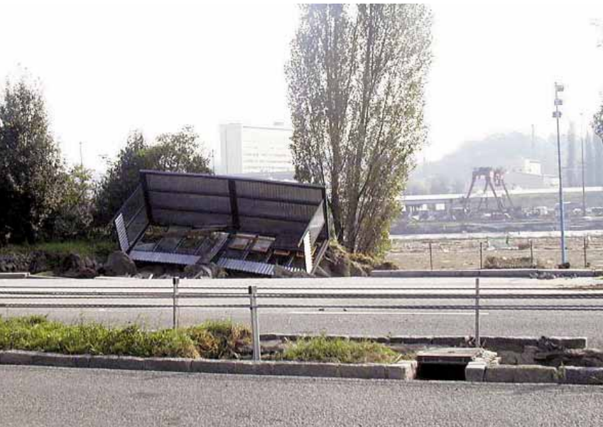
Přístřešek v zastávce Dostihová položila velká voda doslova na „záda“, stejně jako celou autobusovou dopravu téměř na dva týdny.
