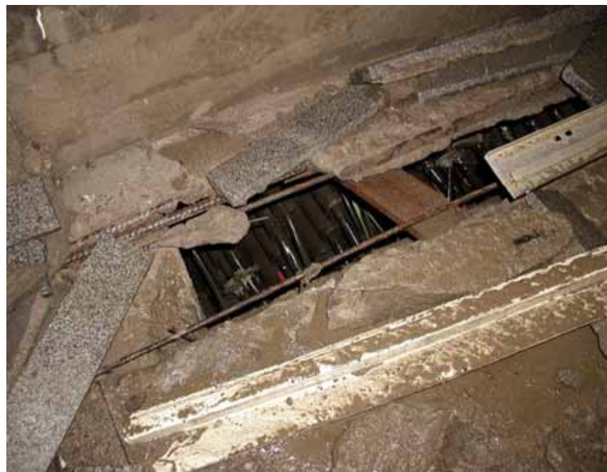
Detail místa, kde si voda našla cestu z prostor tratě B do prostor tratě A ve stanici Můstek.
