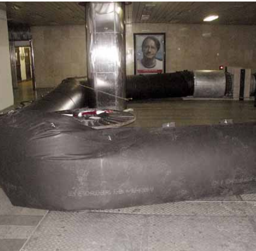
Z důvodu nebezpečí vyšší hladiny CO 2 a metanu je potřeba všechny stanice větrat. Na Můstku k tomuto účelu slouží zobrazený ventilátor.
