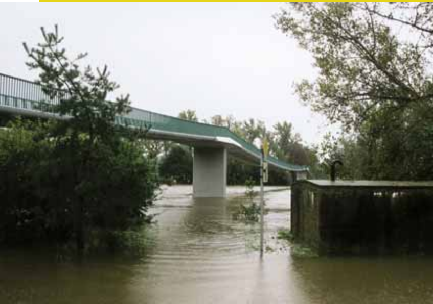
Lávka v Troji, postavená po poslední pražské povodni, tentokrát přežila, ale vyjádření statika do uzávěrky nebylo známé.
