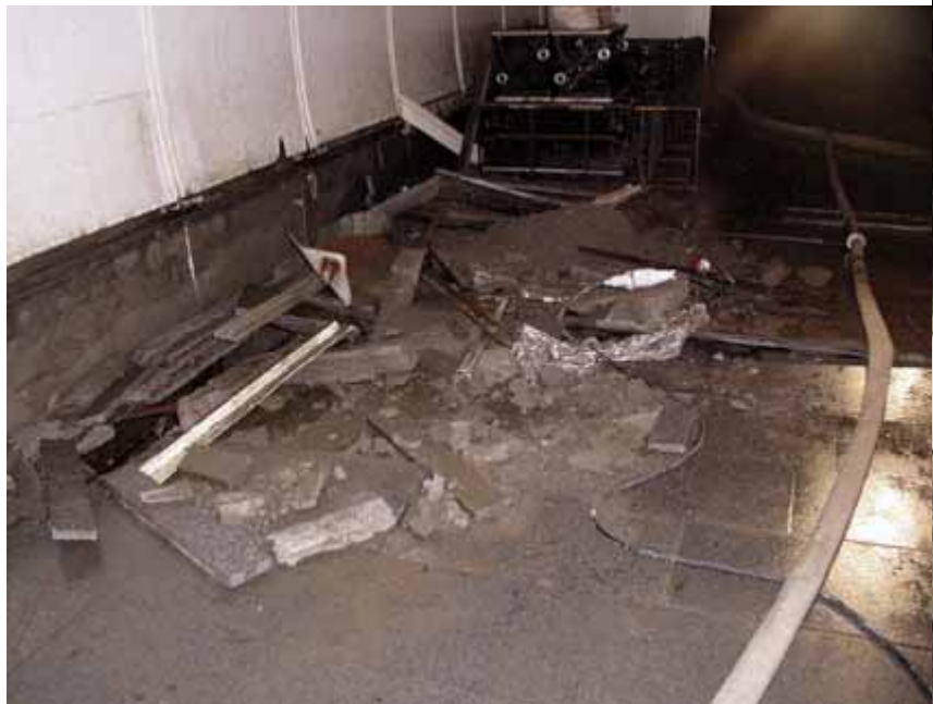
Ve stanici Můstek si voda našla cestu z prostor tratě B do prostor tratě A přes kabelové prostupy.
