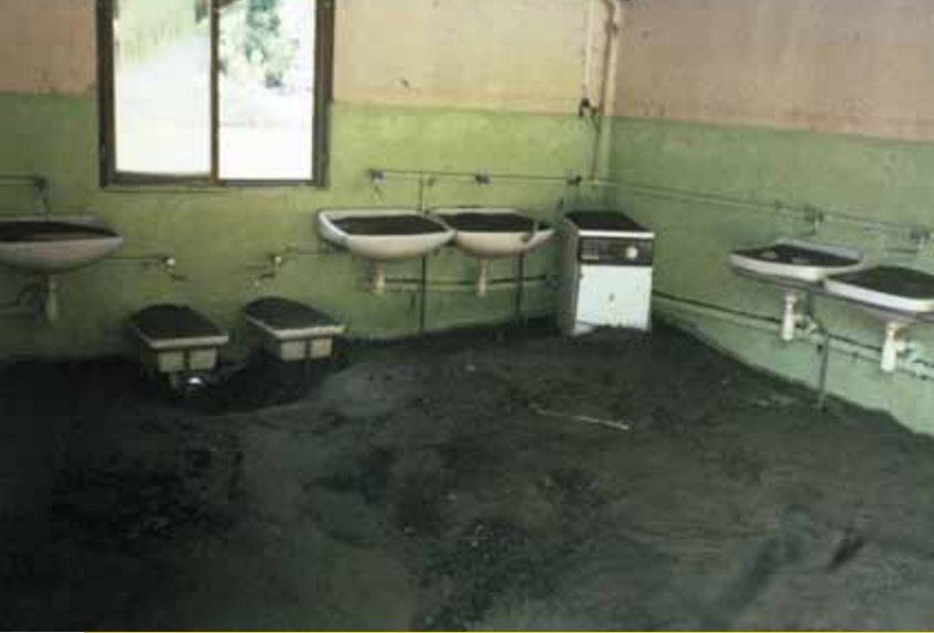
Sociální zařízení v Nuzičích po opadnutí velké vody.
