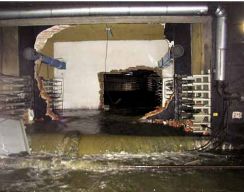
Provalená stěna u zkratovačů ve stanici Palmovka.
