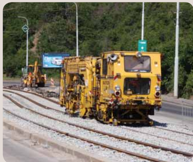
Již v první polovině července se u Krematoria Motol strojně podbíjely dlouhé úseky trati z kolejnic S49.
