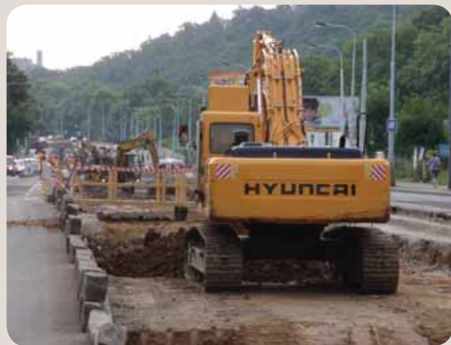
V mimořádném tempu se rozeběhly práce na RTT Plzeňská. Jde o největší rekonstrukční počín porevolučních dob.
