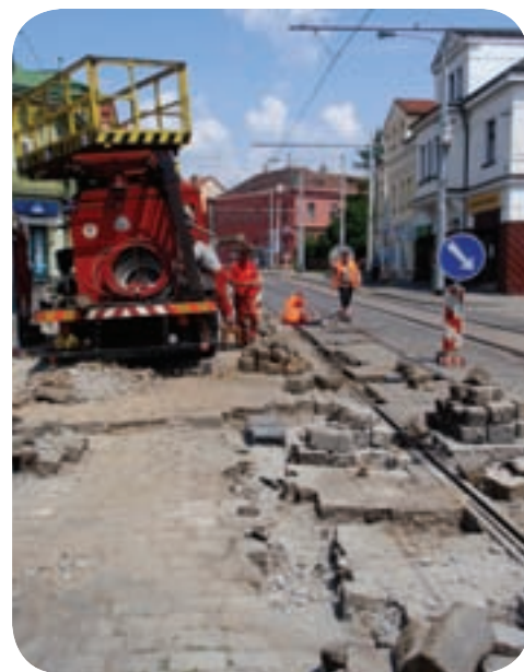
Rekonstrukce troleje v Klapkové ulici se týkala i výhybky u zastávky Ke Stírce.
