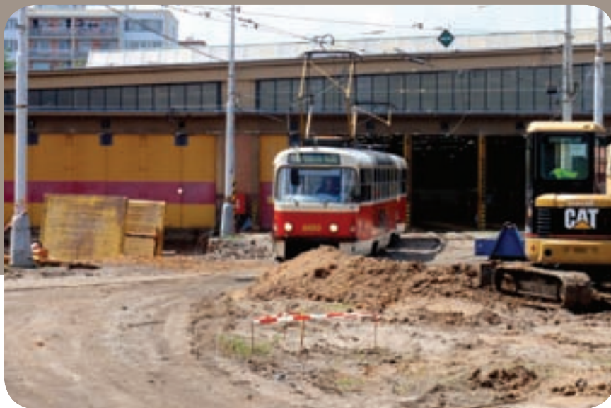
Jeden z posledních výjezdů ze starého dvora vozovny Kobylisy. Tramvaj projíždí stavenišťem odpoledne 30. června 2009.
