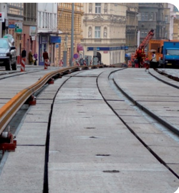
Již osmý (21. května 2008) den po přerušení provozu byly pod Ověneckou ulicí vyměněny všechny panely a svařovaly se kolejnice.
