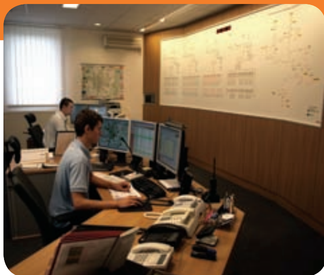
Srdce českobudějovické dopravy – modernizované a rekonstruované centrální dispečerské pracoviště.
