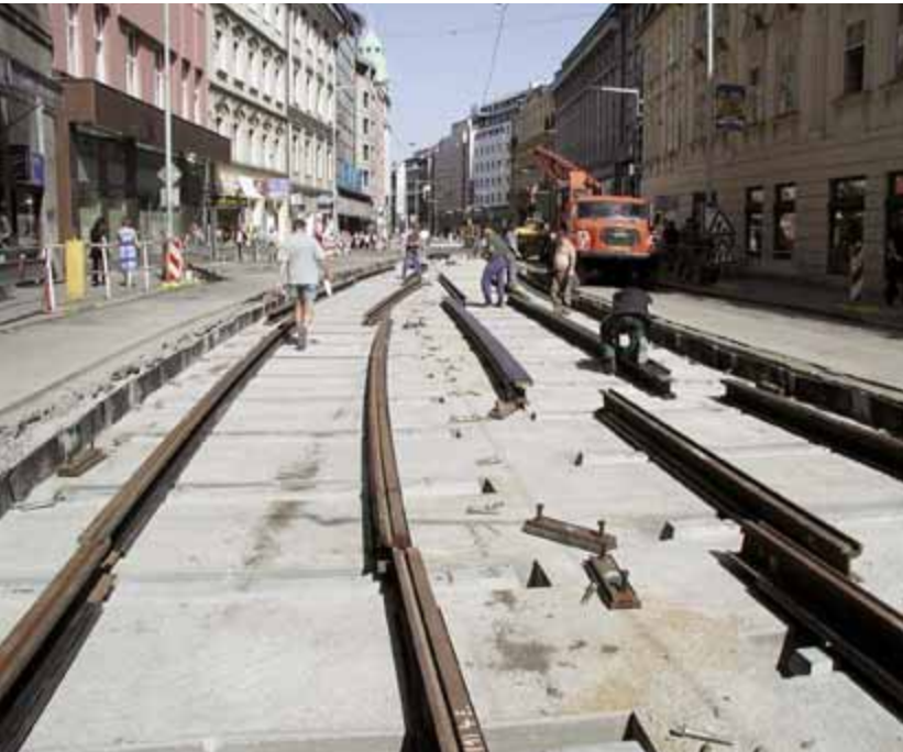
Po vybetonování hlavní plochy se do vynechaných otvorů vloží pražce a paty kolejnic se obalí pryžovým profilem.
