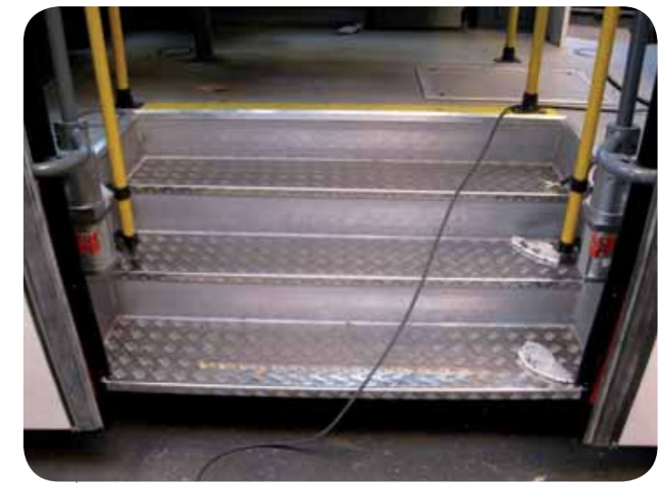
Schody po částečných opravách dostávají kromě nové konstrukce i hliníkový – tzv. slzičkový plech
