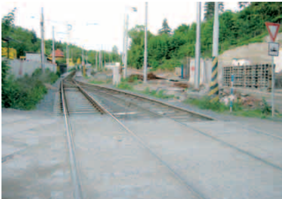
Kolejová splítka na tramvajové trati v Trojské ulici během výstavby metra do Kobylis (20. května 2003). Foto © Pavel Fojtík
