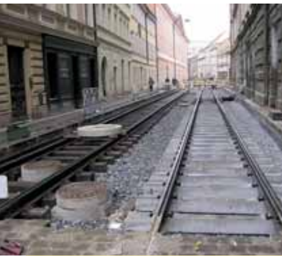
Za křižovatkou s Hellichovou ulicí jsou již smontovaná kolejová pole. Dřevěné pražce jsou použity v místech malé tloušťky štěrkové vrstvy a také v místech nedosta- tečné šířky (snadněji se zkracují).
