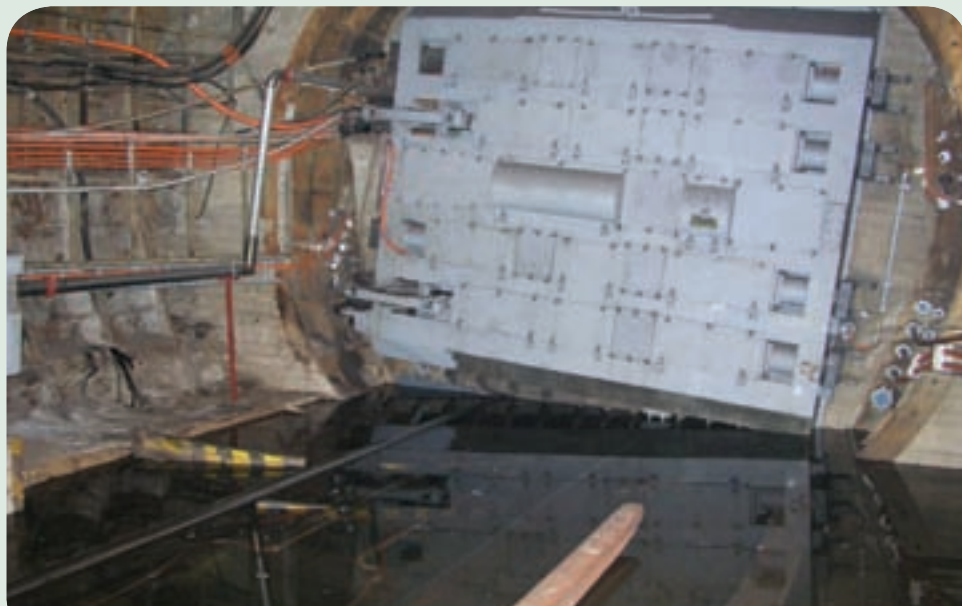
Po zkušenostech z povodní v roce 2002 se hodně úsilí věnovalo tlakové ochraně, a zejména spolehlivosti a zdokonalení konstrukce průchodek. Na snímku zavřený traťový uzávěr při zátopové zkoušce. Průchodky jsou dobře viditelné napravo od tlakového uzávěru. Traťové uzávěry byly konstruovány k oddělení jednotlivých ochranných úseků OSM. Při bezchybné funkci se jejich využití pro mimořádné situace přímo nabízí.
