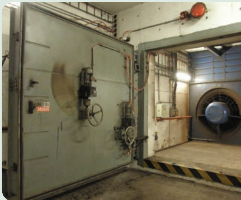
Větrací objekt je typickým příkladem, kde můžeme vidět společně zařízení pro OSM a DSM. Tlakový uzávěr v otevřené poloze je v popředí a vzadu je vidět menší část jednoho ze dvou ventilátorů hlavního větrání.
