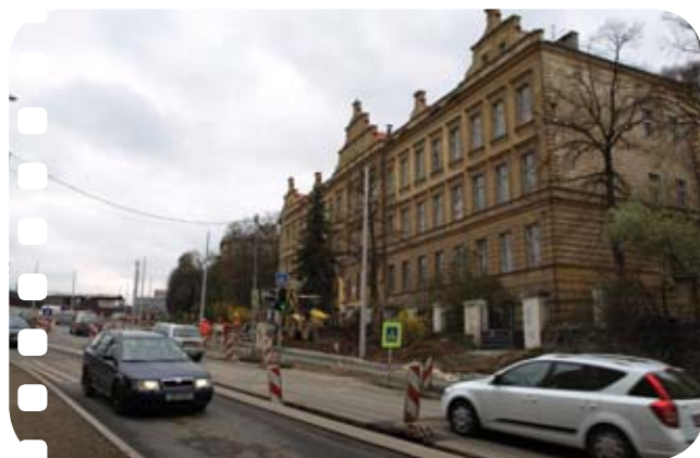
↑ Před školou v Radlicích, kde bude na nové trati i zastávka, přivezly tramvaje první cestující před 81 lety – 16. června 1927. Naposledy sem tramvaj přijela poslední říjnový den roku 1983. Současná výluka tratě v Radlické je zatím naplánována tak, aby tramvaje po novém úseku začaly jezdit už 15. září letošního roku.
