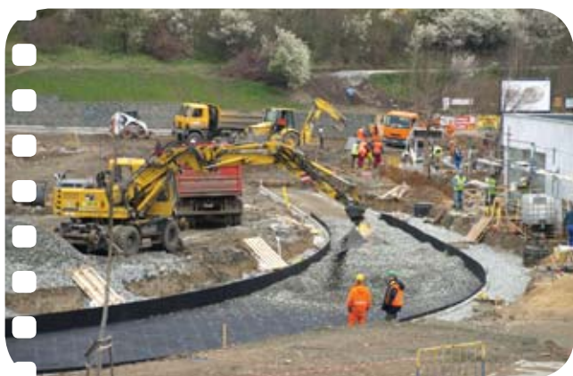
↑ Na zemní pláň budoucí smyčky už byla položena tzv. podšterková rohož, která má působit proti šíření zemních vibrací, a začínalo se s nasypáváním štěrku.
