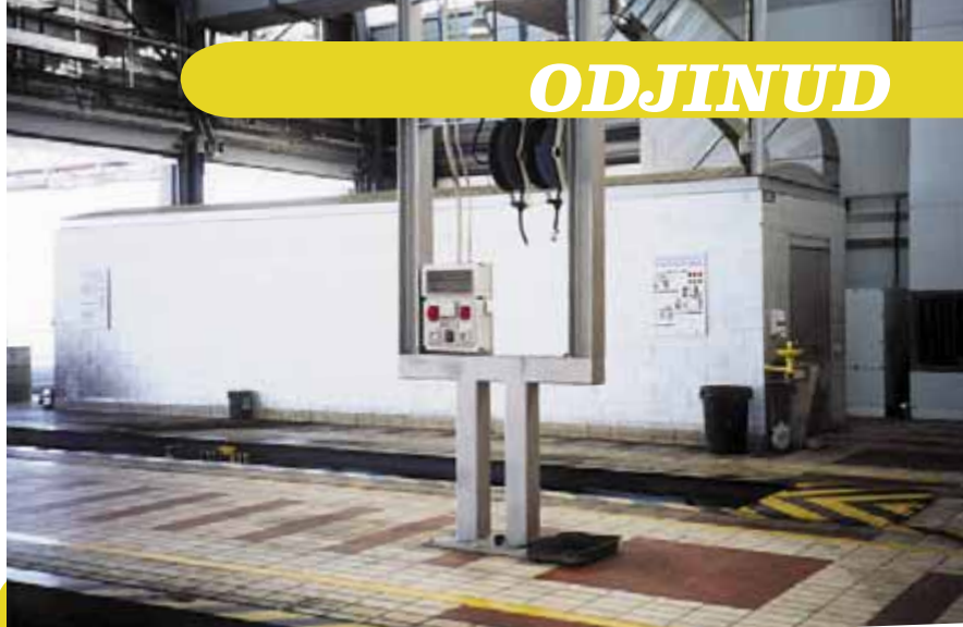
Speciální sklad hořlavých a výbušných látek. Výbušnému prostředí odpovídá speciální elektroinstalace a podobně.
