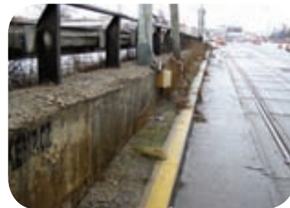
Podjezd na Těšnově a zárubní zdi volají po rekonstrukci.
