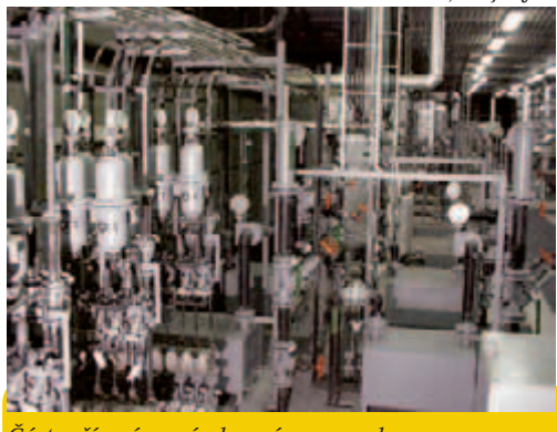
Část zařízení na výrobu a úpravu vody.
