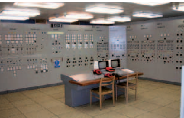
Jeden z technických velinů. Tento je energetický a zajišťoval distribuci elektřiny pro zařízení ochranného systému metra. V případě potřeby ji vyráběly náhradní zdroje.
