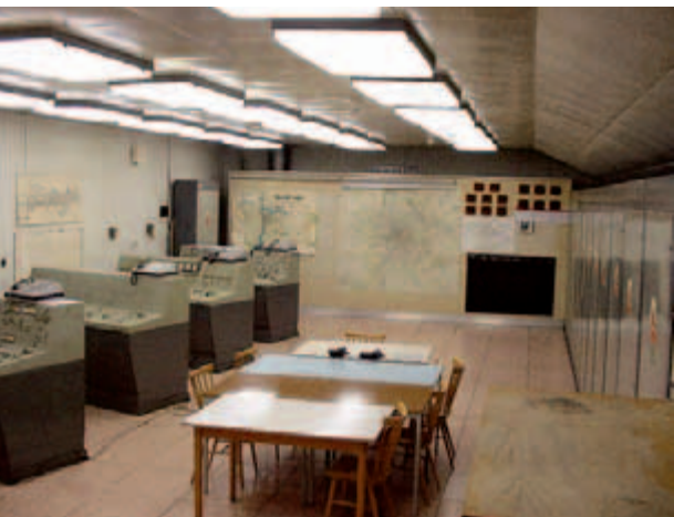
Řídicí centrum technického centra. Nadřazené tomuto pracovišti bylo centrální řídicí pracoviště. V případě potřeby bylo možné stanici řídit samostatně ze staničního řídicího pracoviště.
