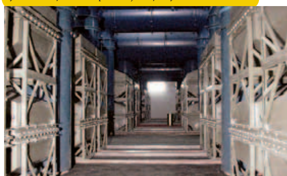
Dodávka vzduchu pro ukryvané byla zajištěna podle situace zamoření venkovního vzduchu. V případě potřeby byl vzduch filtrován přes bojové filtry.
