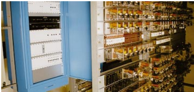
Staniční zabezpečovací zařízení AZD 71 a skříň MATRA PA-135
