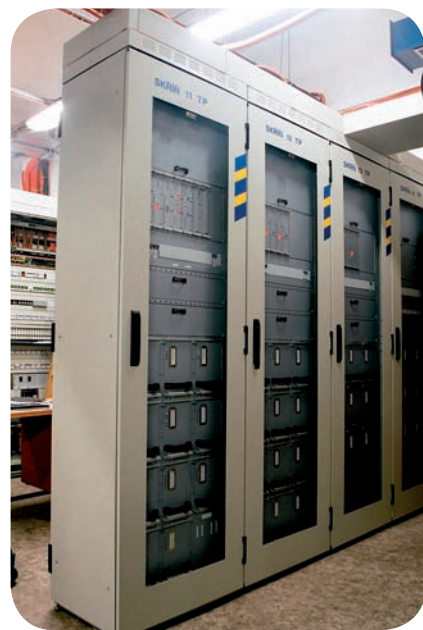
↑ Technologická část elektronického stavědla ESA 11M.
