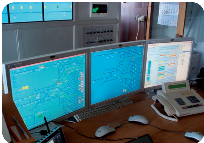
↑ Komunikační rozhraní pro lokální obsluhu ASDR-D a elektronického stavědla, zleva: subsystém ASJC, elektronické stavědlo ESA 11M a subsystém IČV (Depo Hostivař).
